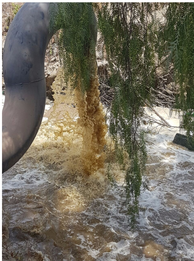
Immagine 1: Tubo di scarico delle acque residuali domestiche non trattate sul fiume Cuenca Verde. Fonte: produzione Yaku.
